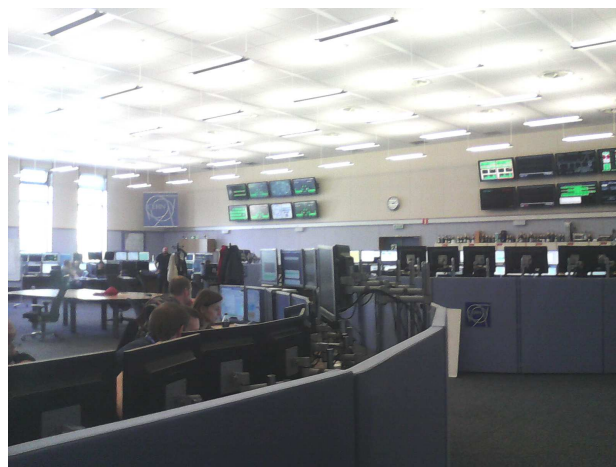
La salle de contrôle général.
